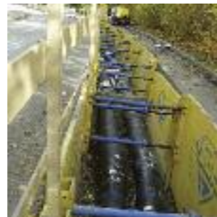
Effiziente Verteilung des warmen Wassers zur Heizung durch gut gedämmte Rohre
